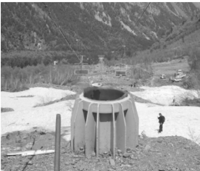
Срезанная опора канатной дороги, 2005 г.
